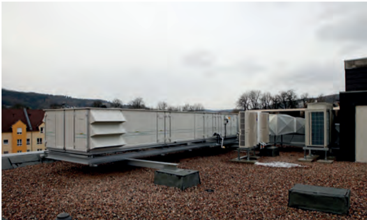
Aufstellung der Klima- und Lüftungsanlagen auf dem Dach
