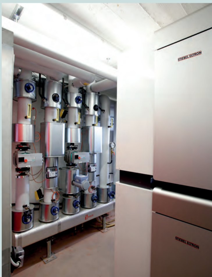
Wärmepumpen-Kaskade versorgt die Fußboden- und Luftheizung
