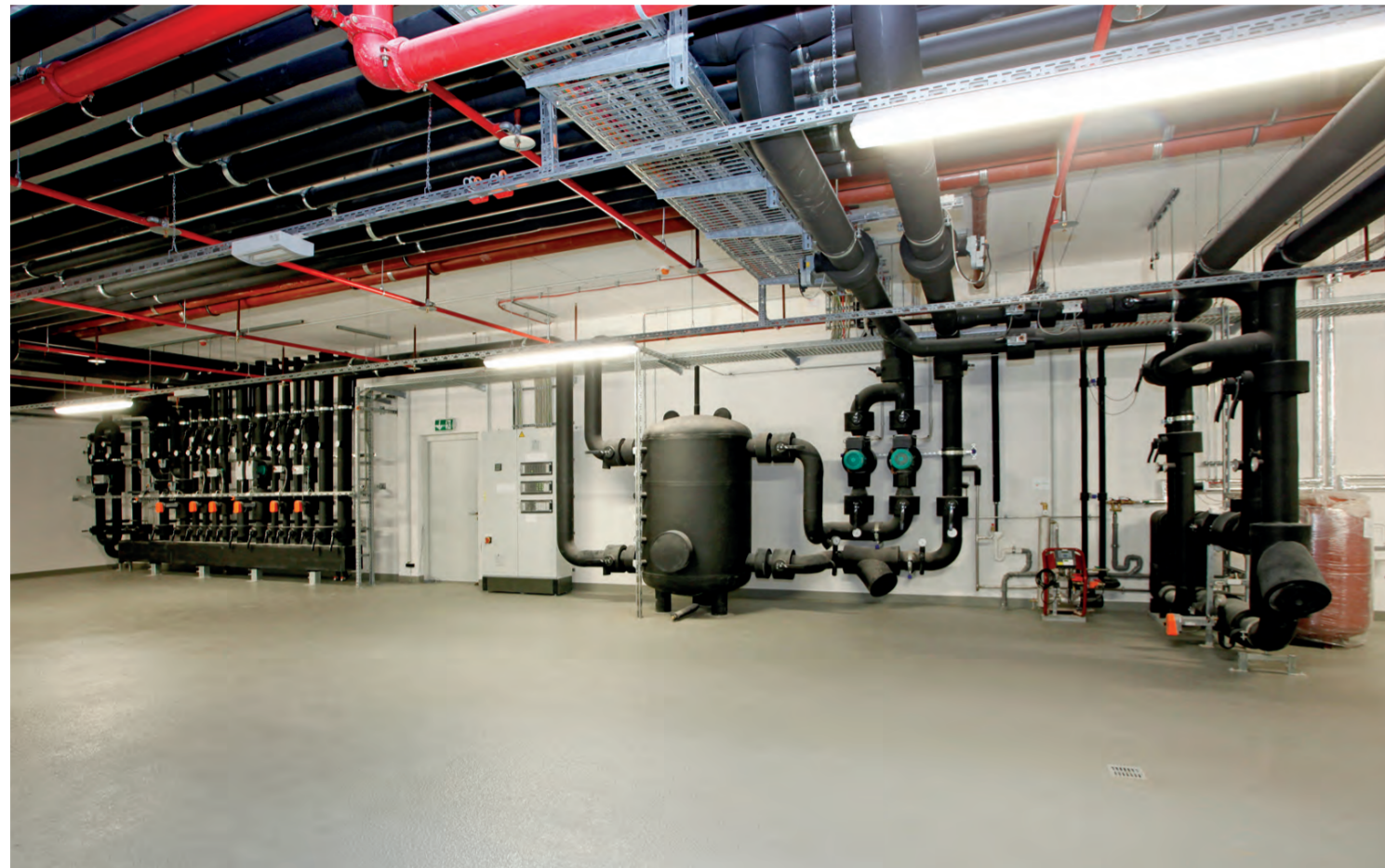
Blick in die Kältezentrale
