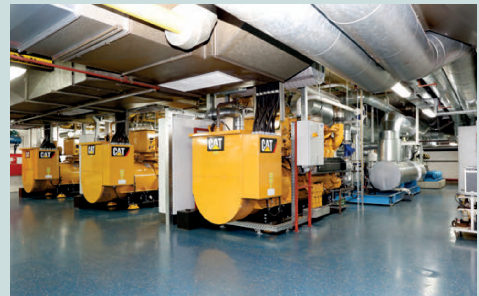
Blick auf die BHKWs in der Zentrale
