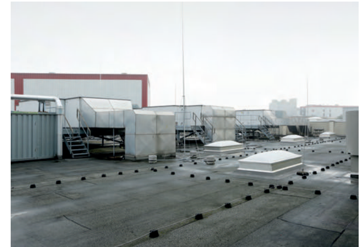
Blick auf die Dachzentrale
