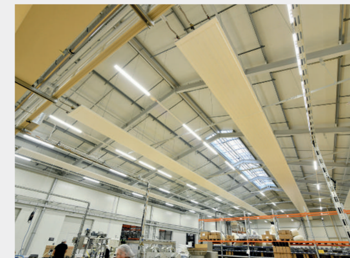
Deckenstrahlungsheizung in der Produktionshalle
