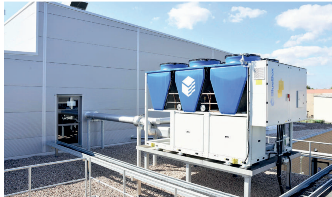
Kompaktkaltwassersatz zur Kälteversorgung
