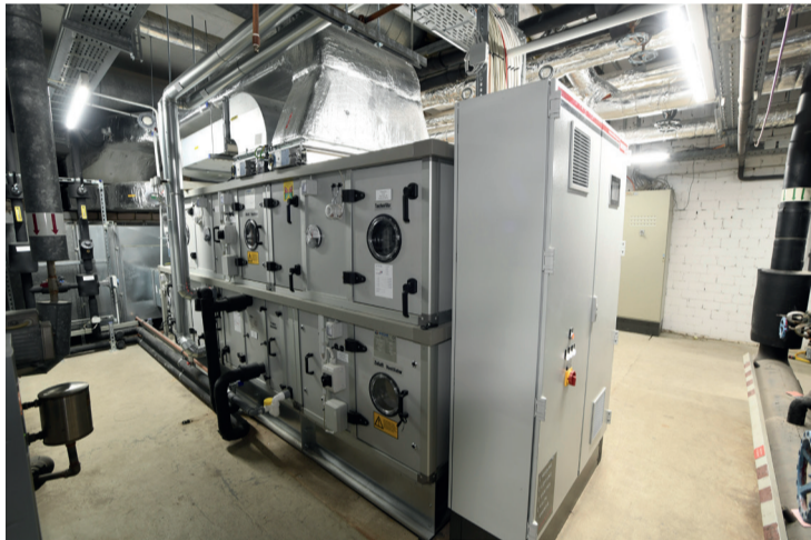
Kompaktkaltwassersatz und Lüftungsgerät
