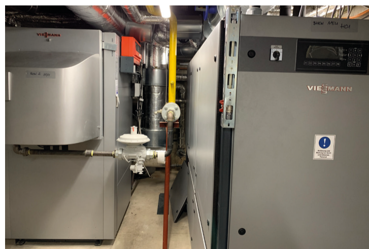
Der neue Wärmeerzeuger mit dem ergänzenden Blockheizkraftwerk zur Erzeugung von Wärme und Strom
