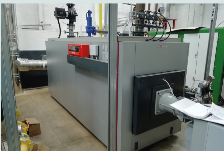
Gasbrennwertkessel während der Inbetriebnahmearbeiten
